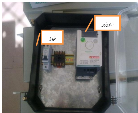
شکل ۱- اینورتور و فیوز سوار شده روی تابلو
