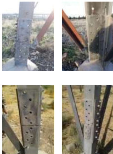
شکل ۱- سرقت پیچ‌های اعضای متصل به هم در قسمت پایه دکل‌های انتقال نیرو
