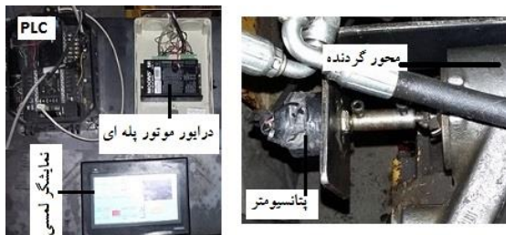
شکل ۶- اجزای واحد کنترل کننده سامانه الکترو هیدرولیکی Fig 6. Components of the electro-hydraulic control system
