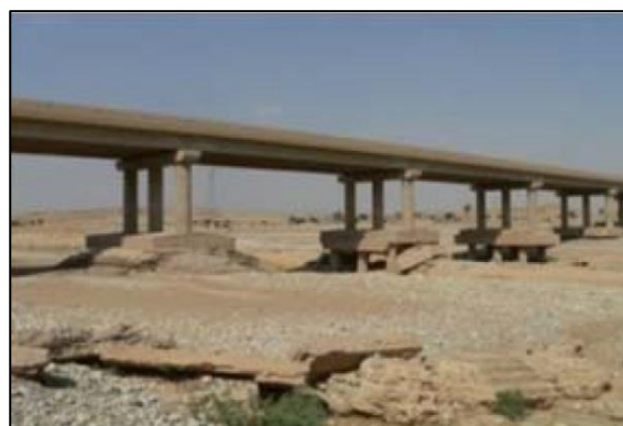
شکل ۲- تخریب ناشی از آبشستگی (پل گلال کهنک).
